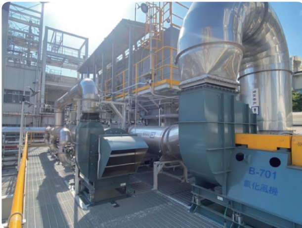
增設污染防治設備 (蓄熱式焚化爐)
