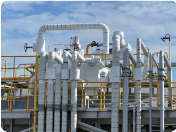
洲際碼頭區設置直燃式焚化爐
