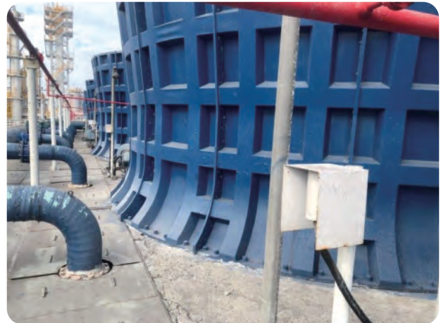
冷卻水塔旁空氣監測器
