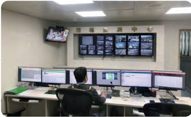
仁武廠南部環境監測中心
